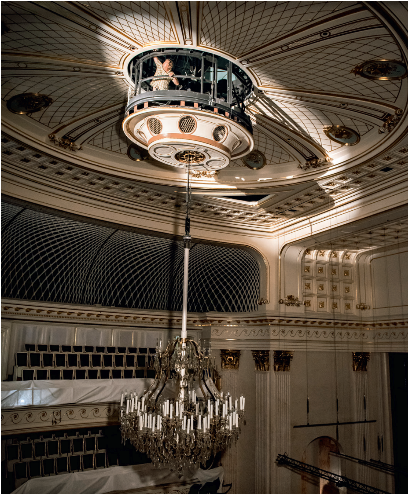
VERSTECKTE TECHNIK: OLAF FREESE, LEITER DER BELEUCHTUNGSABTEILUNG, BEI DER MONTAGE VON SCHEINWERFERN IN DER KRONENGONDEL
